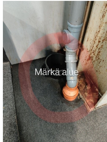
Kuva 15. Vesikaton sadevesiputken juurella märkä lattiamatto
